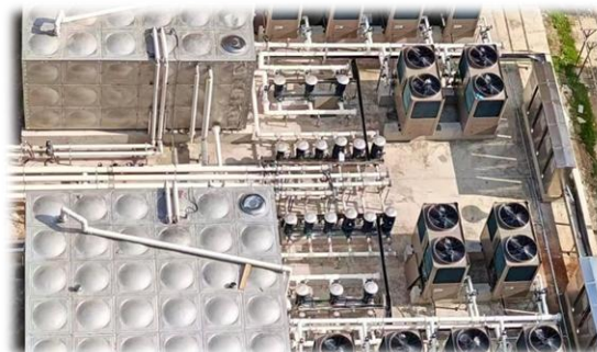
学生宿舍空气能热泵热水系统
